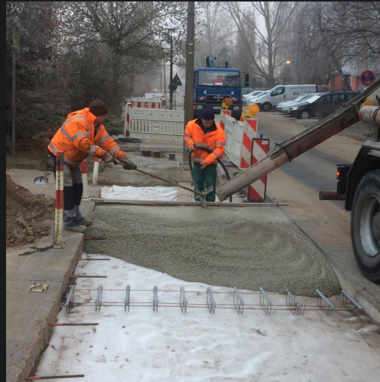
Einbau im Einzelfeld
