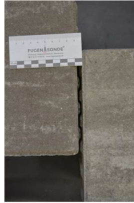
Nicht-verfüllbare Fuge über den Fugenquerschnitt bei nicht hinreichender Fugenbreite.
