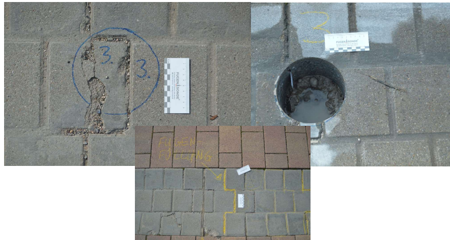
Hohlräume im Fugenquerschnitt einer Rinne aus „Elementsteinen.“
