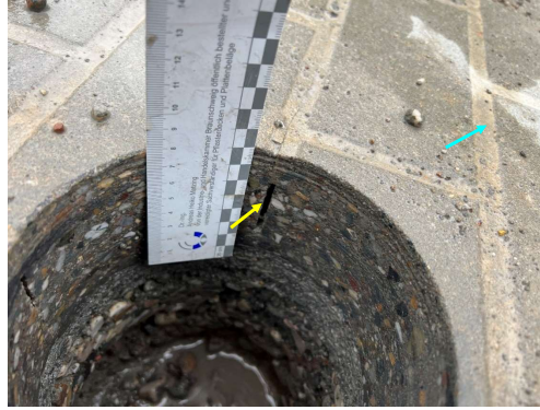
Hohlraum im Fugenquerschnitt einer gebundenen Betonsteinpflasterdecke, überfugte Fuge sichtbar.
